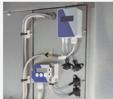
Filterüberwachung und Ventilator-sensorik mit digitaler Anzeige.
