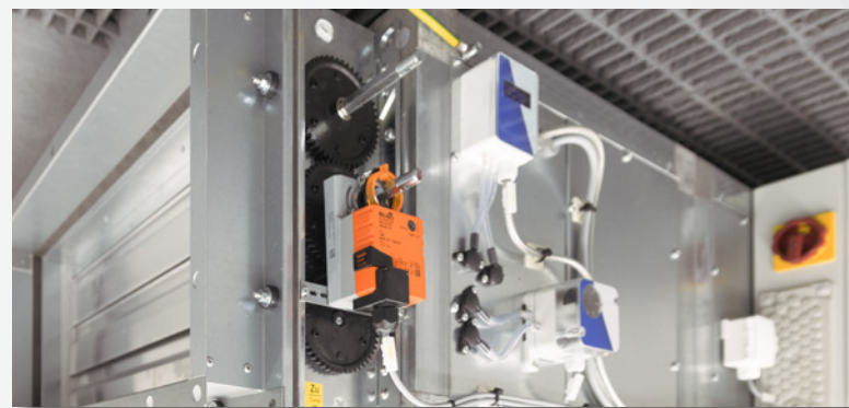
Stellmotor, Filterüberwachung und Ventilatorregelung angebaut und auf Regelung verdrahtet.
